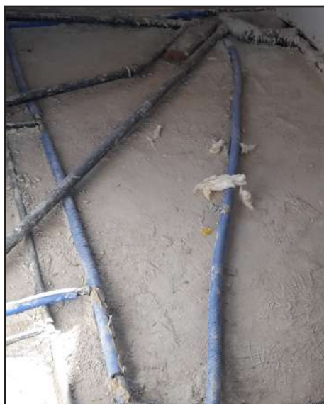
Dettaglio condizioni di partenza del massetto
