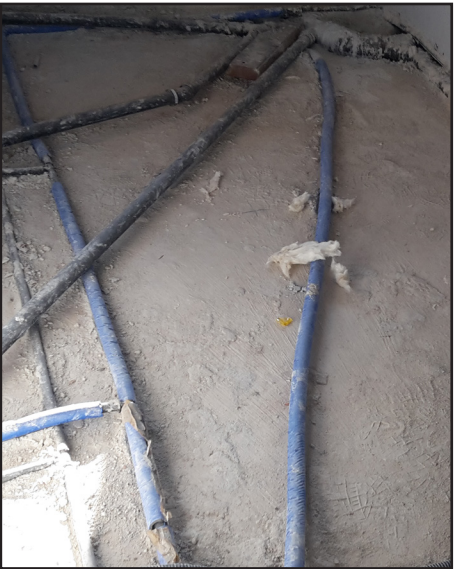
Dettaglio condizioni di partenza del massetto
